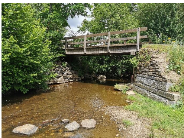
Figure 24 Stabilisation de berge pour la passerelle au niveau du terrain de tennis de Gedinne
