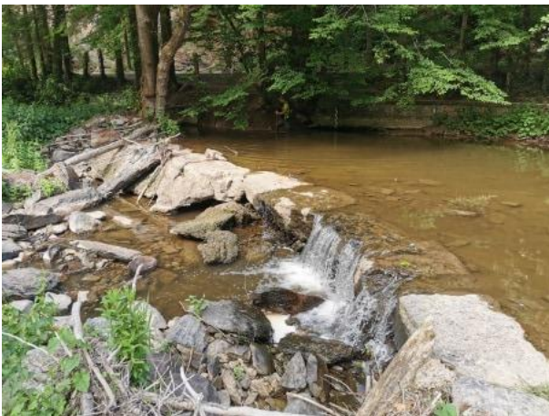
Figure 34 Seuil de la centrale de Vencimont: enrochement en rive droite en amont
